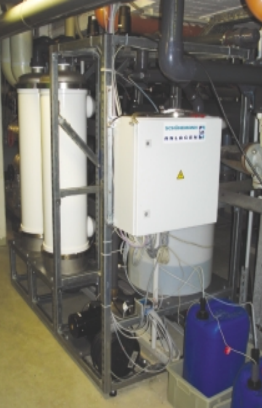
Ultrafiltrationsanlage zur Plansch Becken-Wasser-aufbereitung im Schinkelbad Osnabrück; Foto: Schweinermann Anlagen, Bremen (Abbildung 7)
